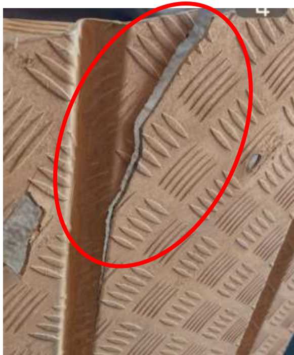
Tapa de batería quebrada
