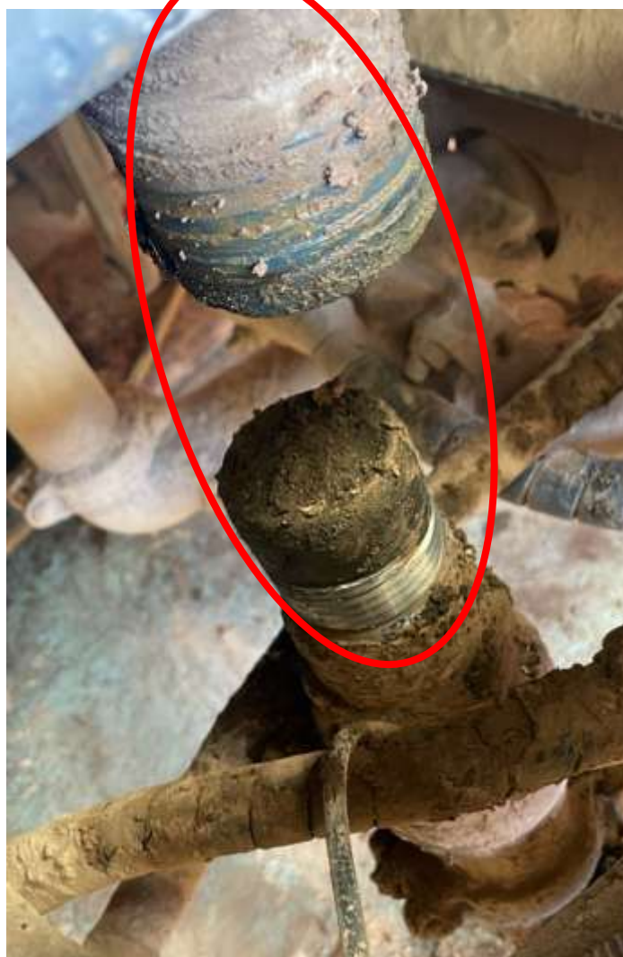
Manguera con presencia de residuos y obstrucción total
