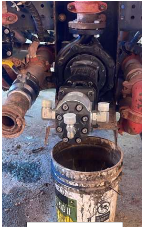
Bomba impulsora instalada
